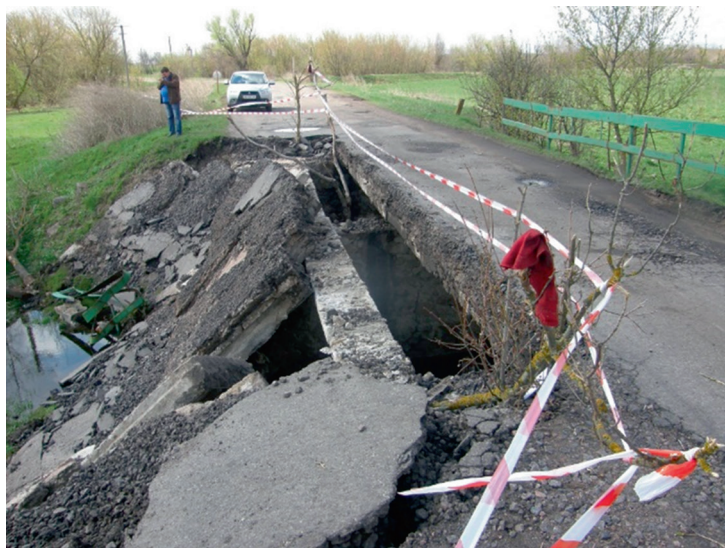
Рисунок 12 — Міст на а/д Т-04-23 км 17+750 (Дніпропетровська область). У результаті підмиву паводком бутових фундаментів зруйнувалися проміжні опори (2015 рік)
