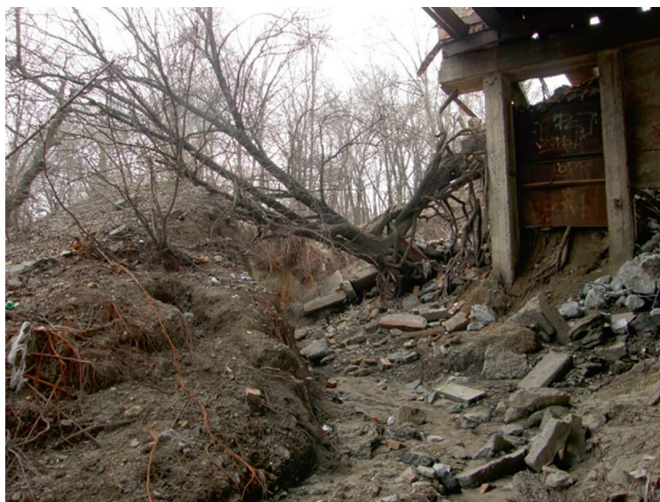
Рисунок 13 — Міст №7 через річку Саксагань у м. Кривий Ріг (Дніпропетровська область). Через недостатнє водовідведення зруйнувався насип лівобережного підходу (2015 рік)
